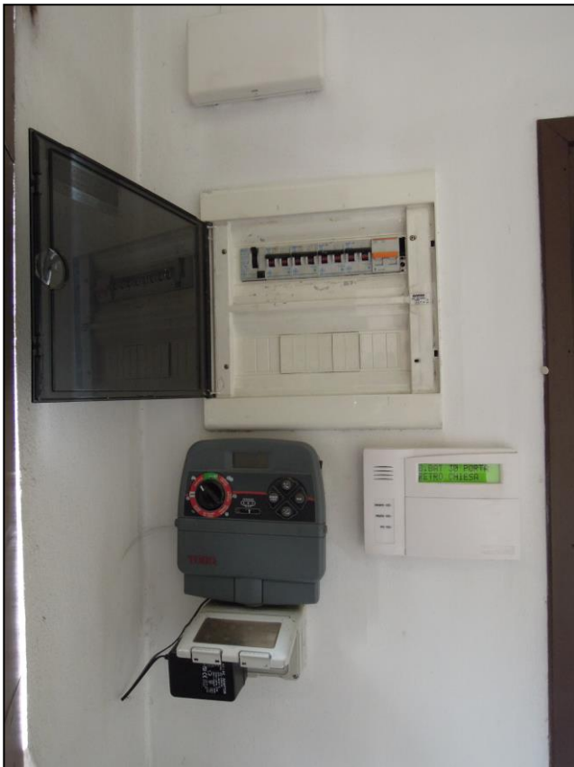
12-13- Interno – quadro allarme
